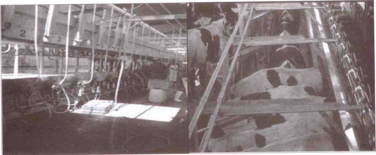
Figura 34. Sala en paralelo.
